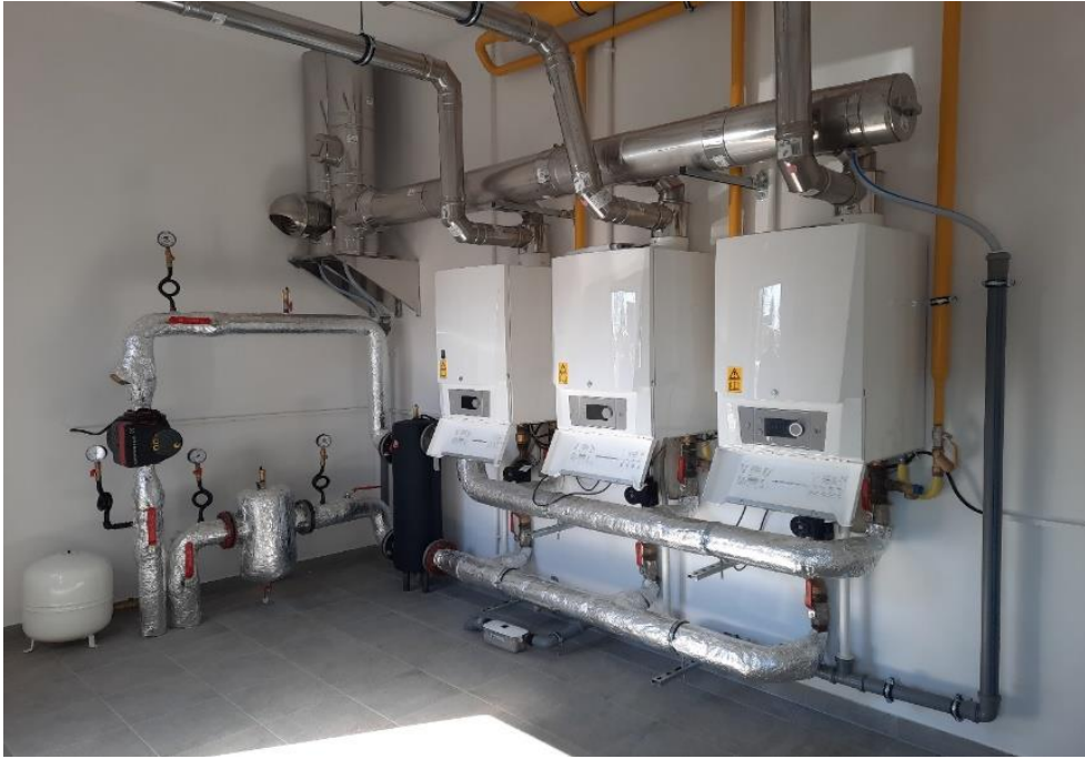
Zdjęcie 6. Wnętrze nowo wybudowanej kotłowni przy Szkole Podstawowej w Kościelcu.
